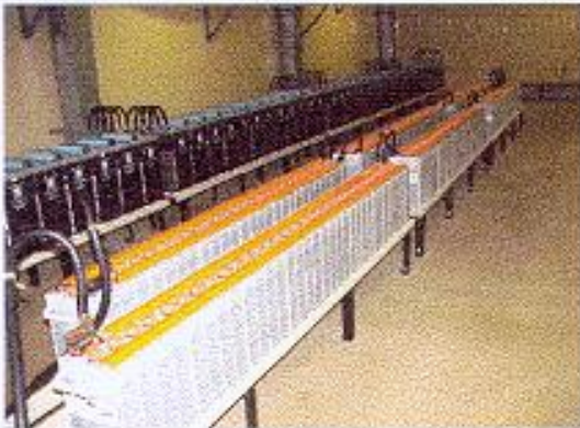
Fig. 7 – En primer plano los nuevos acumuladores incorporados, en tanto mas al fondo se observan los acumuladores aun en uso.
