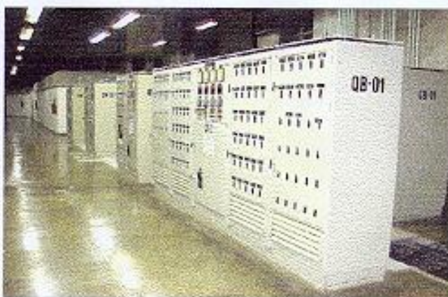
Fig. 5 - Tablero de distribución de cargas de C.C de la CHI.
