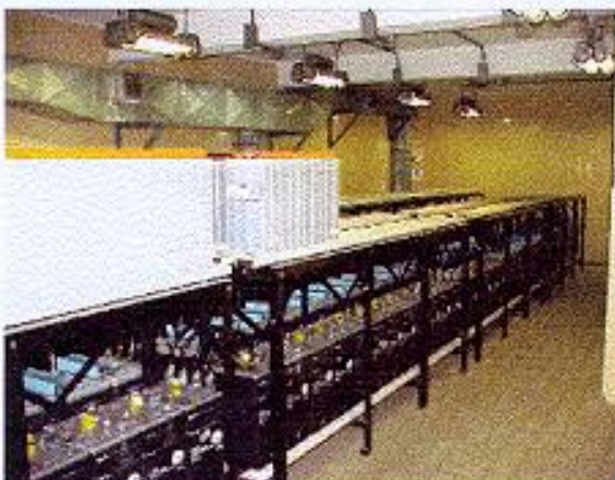
Fig. 9 – Una vez sustituido todos los acumuladores de este grupo, se reducirá notablemente el espacio físico ocupado.
