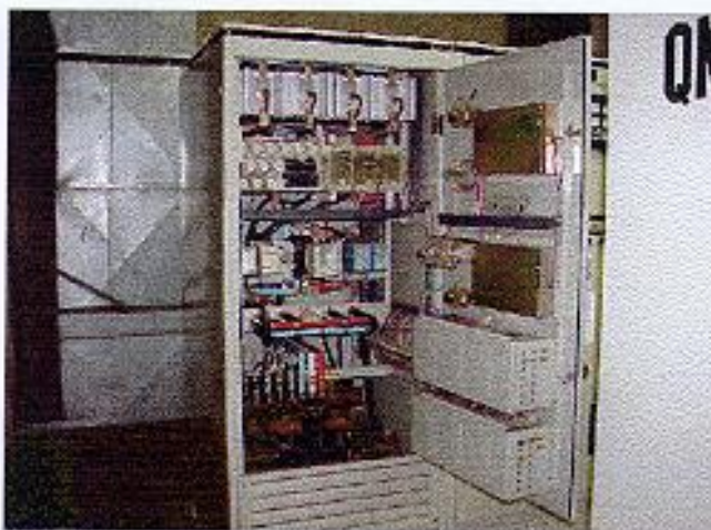
Fig. 6 - Vista interior de un cargador de acumuladores de la CHI.
